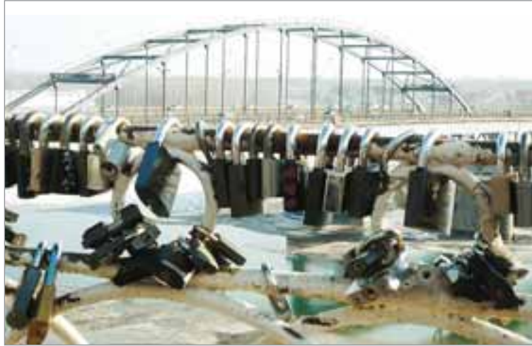
▲ Увесистые «символы любви» нелепым грузом отягощают хрупкое архитектурное сооружение.
